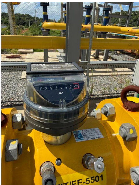
Foto 6.2-3: Medidor de vazão do biometano (FIT/FE-5501) na saída para a concessionária (Fonte: BV, maio/26).
