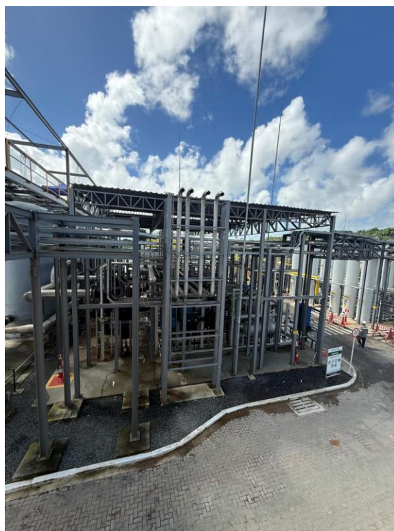
Foto 6.2-4: Vista geral da estrutura da Unidade de Produção de Biometano (Fonte: BV, maio/26).
